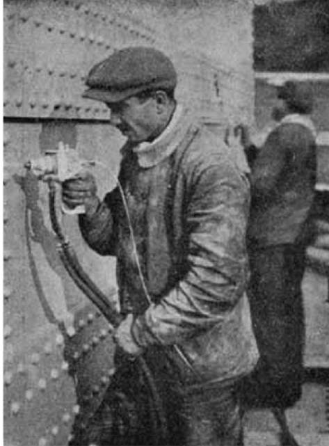
Rys. 7. Cynkowanie wrót śluzy Vauban koło Strass- burga [30]
