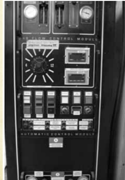
Rys. 2. Szafa sterownicza 7MR Fig. 2. 7MR Control box
