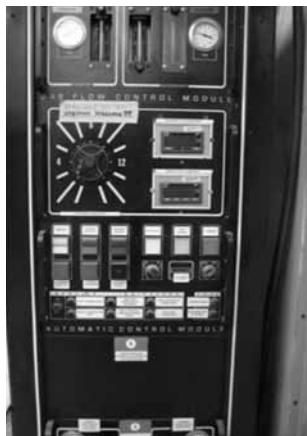
Rys. 2. Szafa sterownicza 7MR Fig. 2. 7MR Control box
