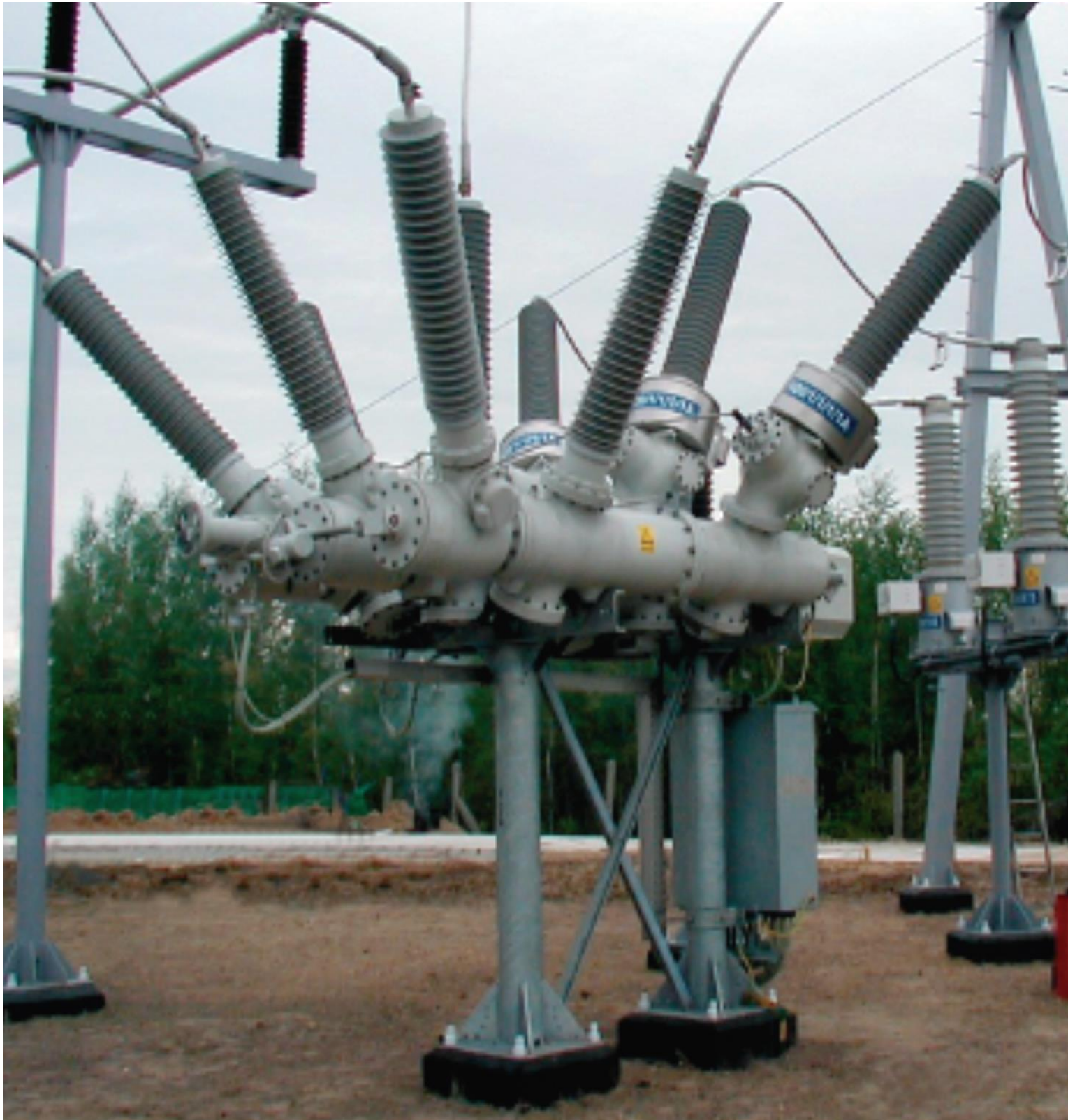
Moduł rozdzielnic PASS M0 do połączenia z podwójnym systemem szyn zbiorczych - pole liniowe.
