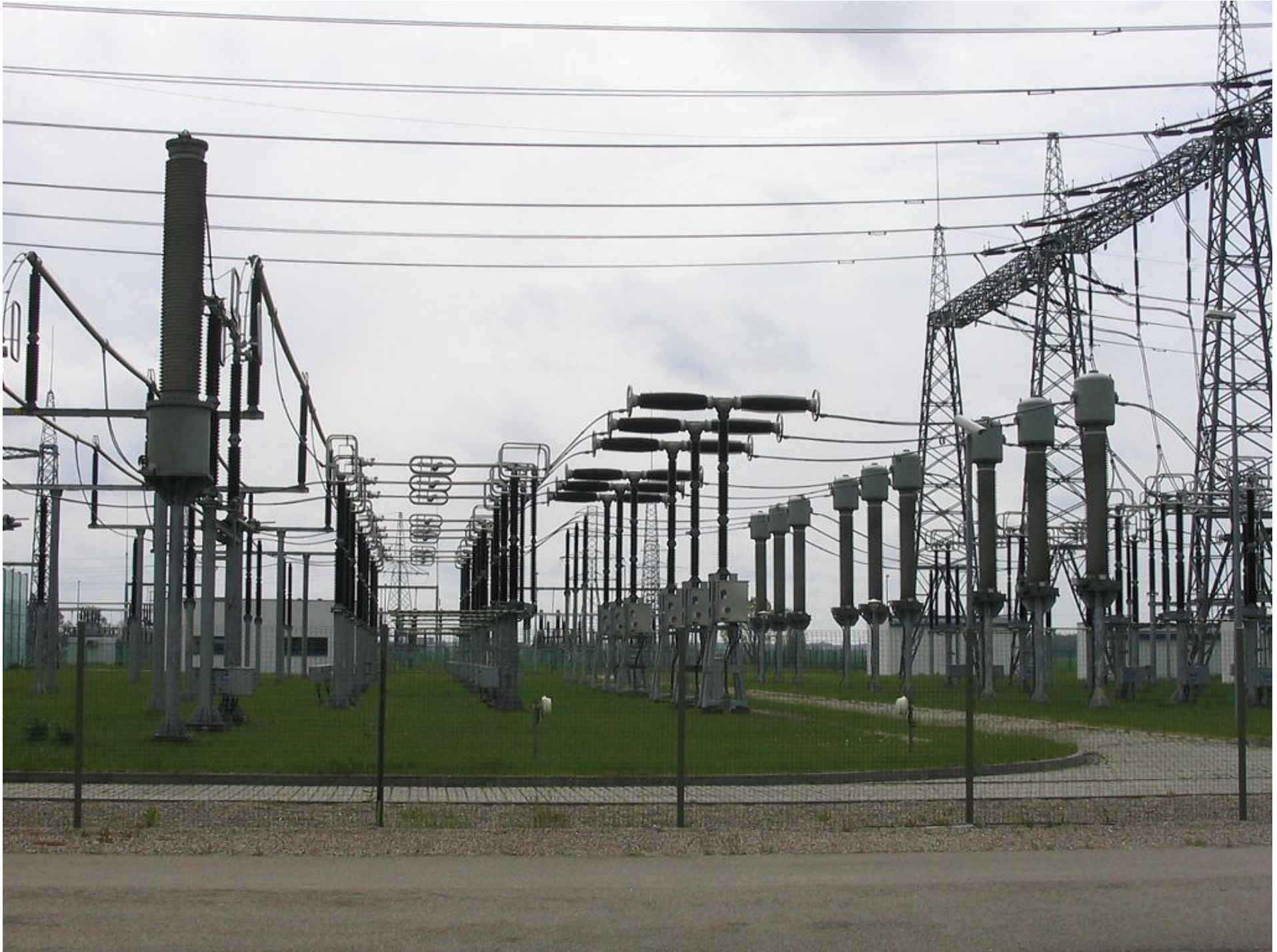
Pola liniowe rozdzielnic 400 kV.
