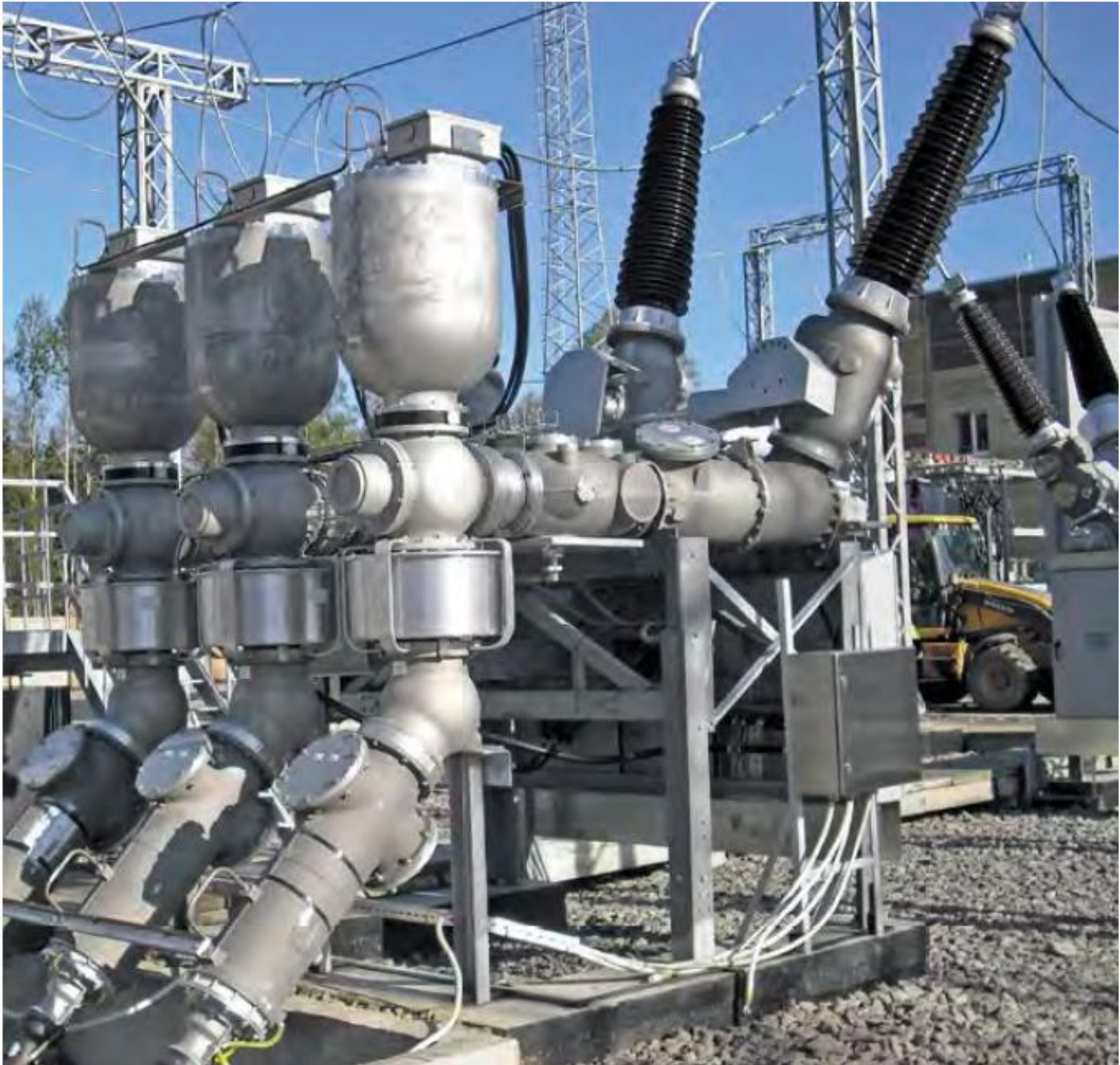
Moduł rozdzielnicy PASS - pole liniowe (linia kablowa).
