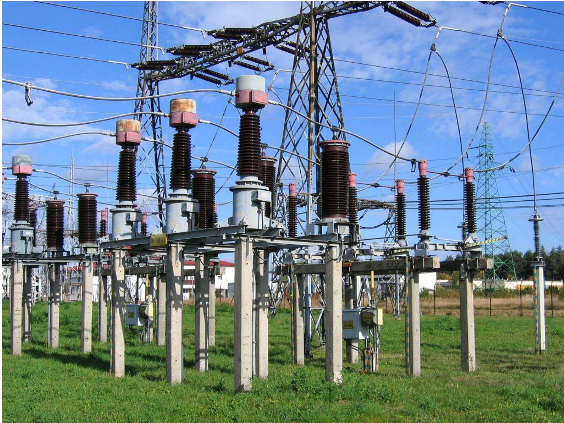
Przekładniki prądowe i napięciowe 110 kV
