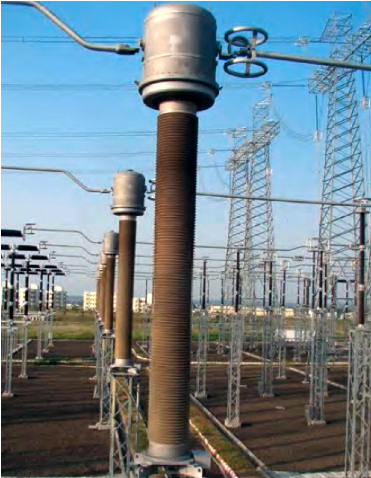
Przekładnik prądowy 800 kV izolowany SF 6
