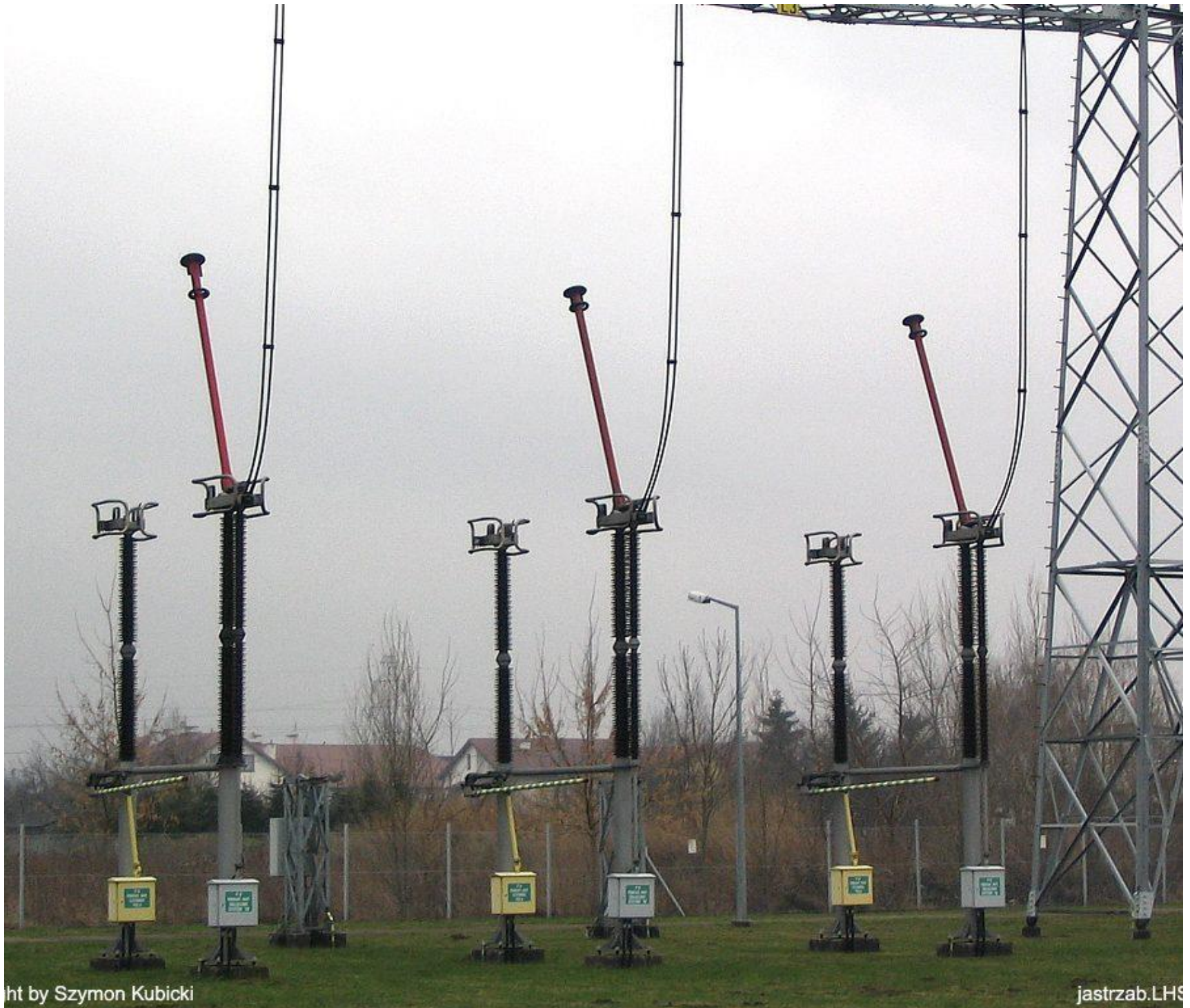
Przykład odłączników napowietrznych pionowoobrotowych jednoprzerwowych 220 kV.
