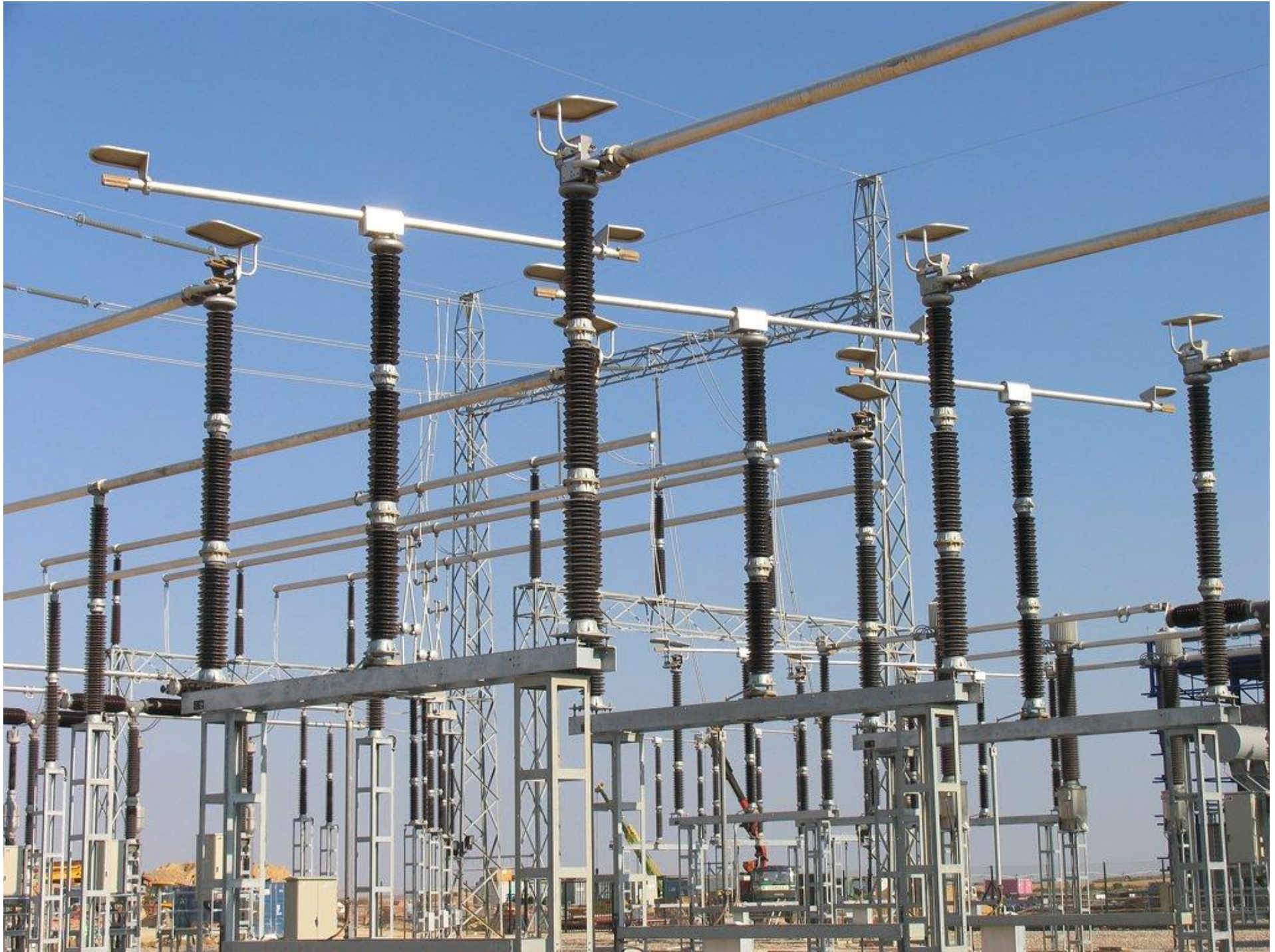
Przykład odłączników napowietrznych poziomoobrotowych dwuprzerwowych 400 kV.
