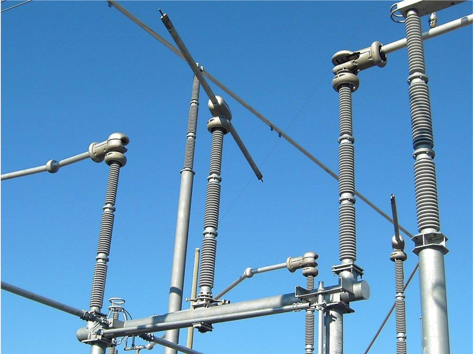
Przykład odłączników napowietrznych poziomoobrotowych dwuprzerwowych 400 kV.
