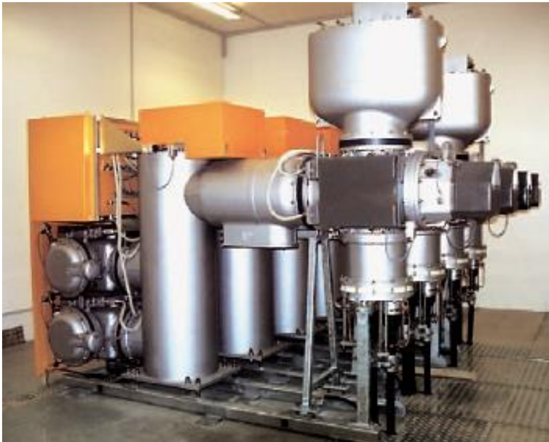
Rozdzielnica wewnętrzna SF 6 typu EXK, 145 kV, 2500 A, 40 kA
