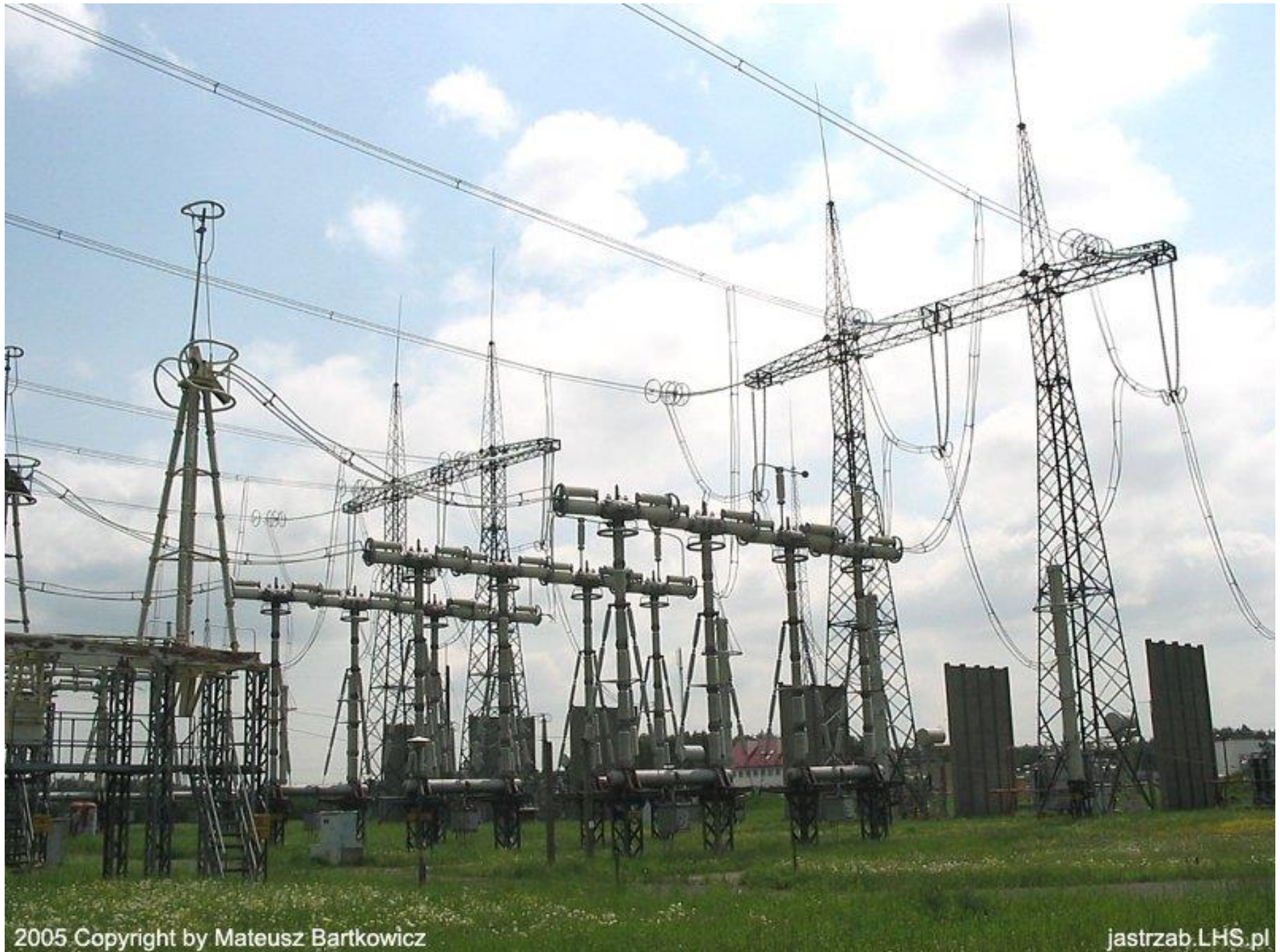
Pole rozdzielnicy 750 kV.
