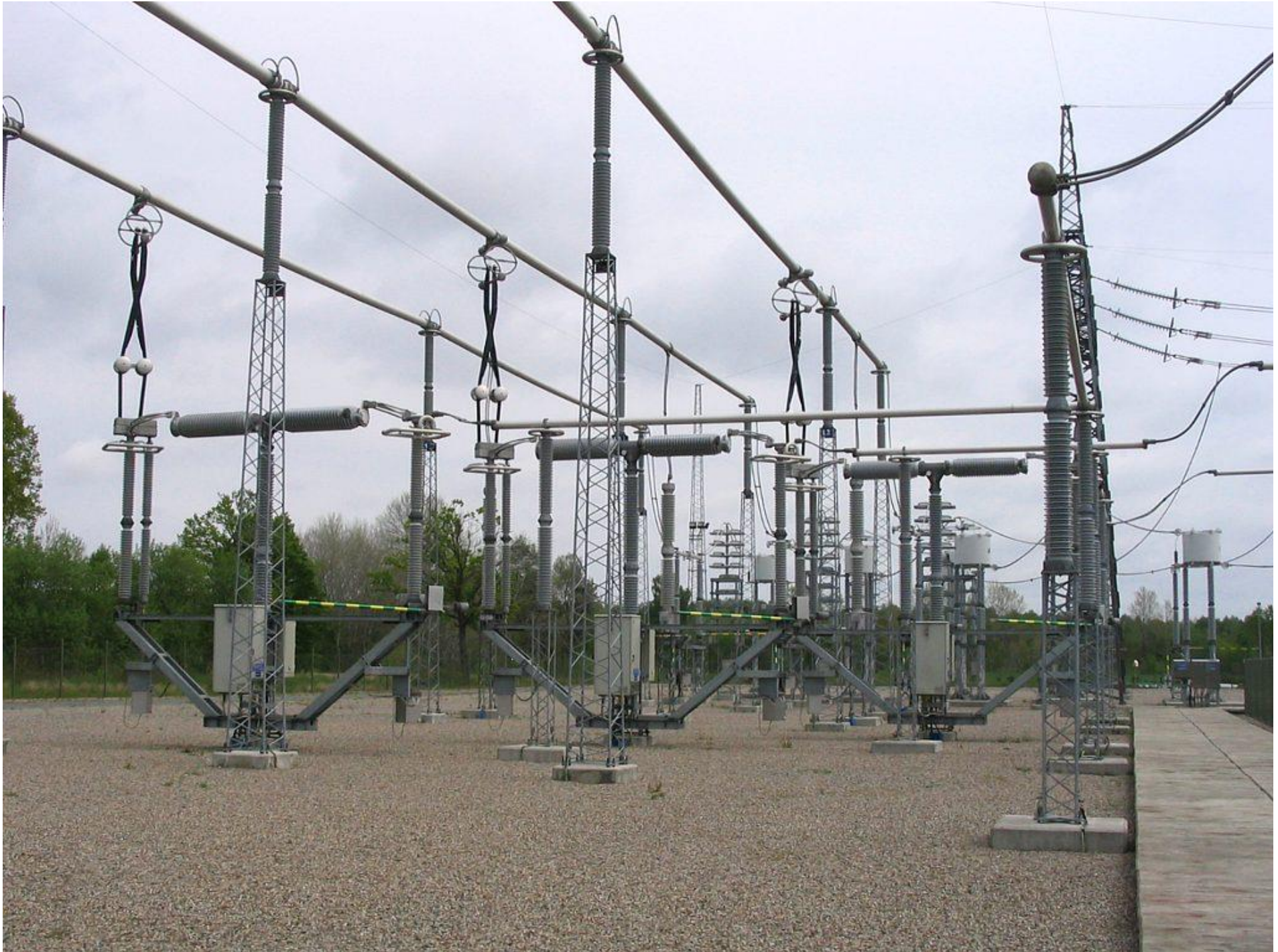
Pole transformatorowe w rozdzielni 400 kV.
