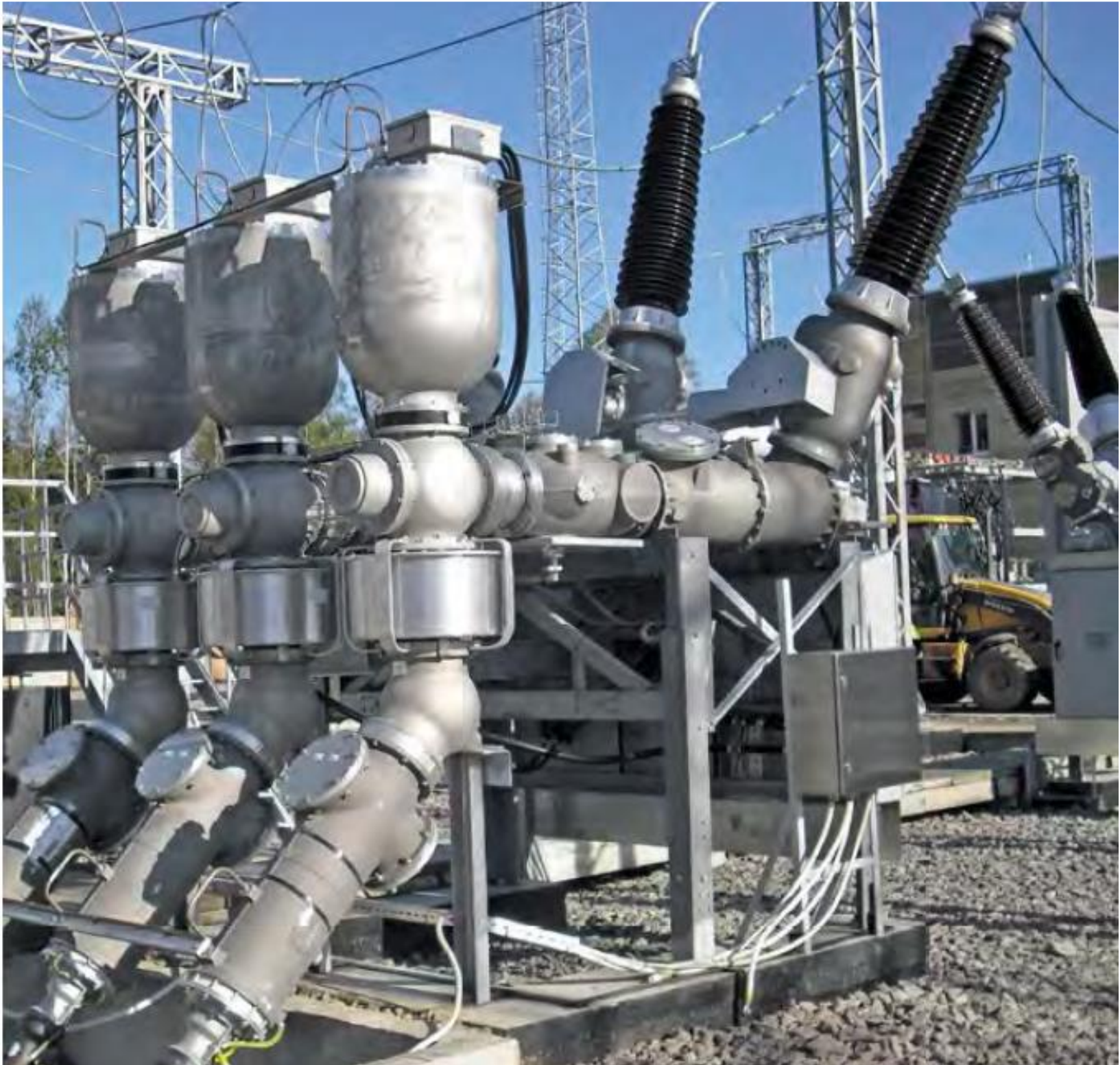
Moduł rozdzielnicy PASS - pole liniowe (linia kablowa).
