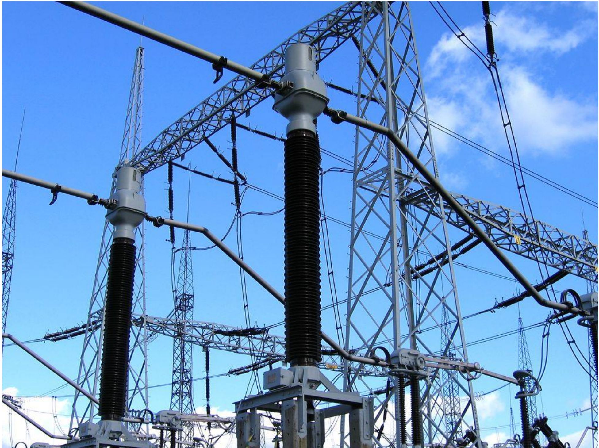
Przekładnik prądowy głowicowy 400 kV
