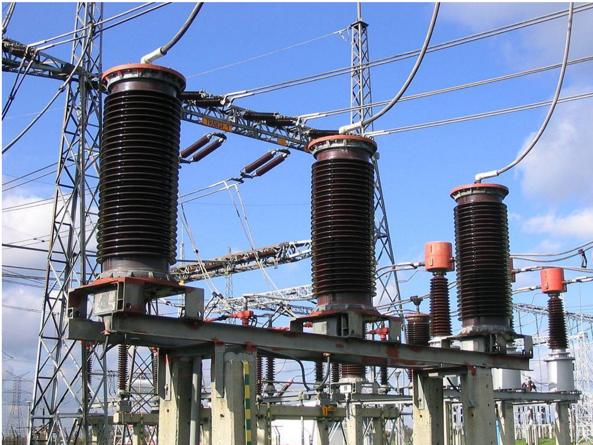
Przekładniki napięciowe 110 kV
