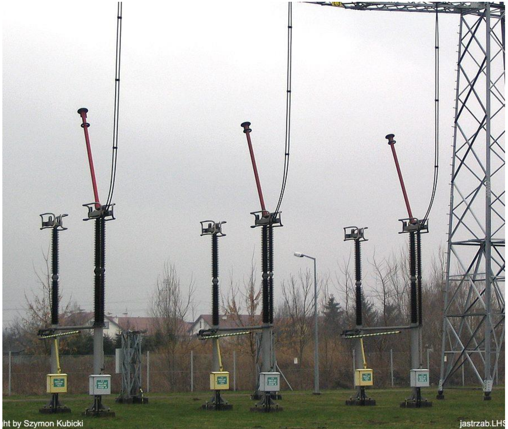
Przykład odłączników napowietrznych pionowoobrotowych jednoprzerwowych 220 kV.
