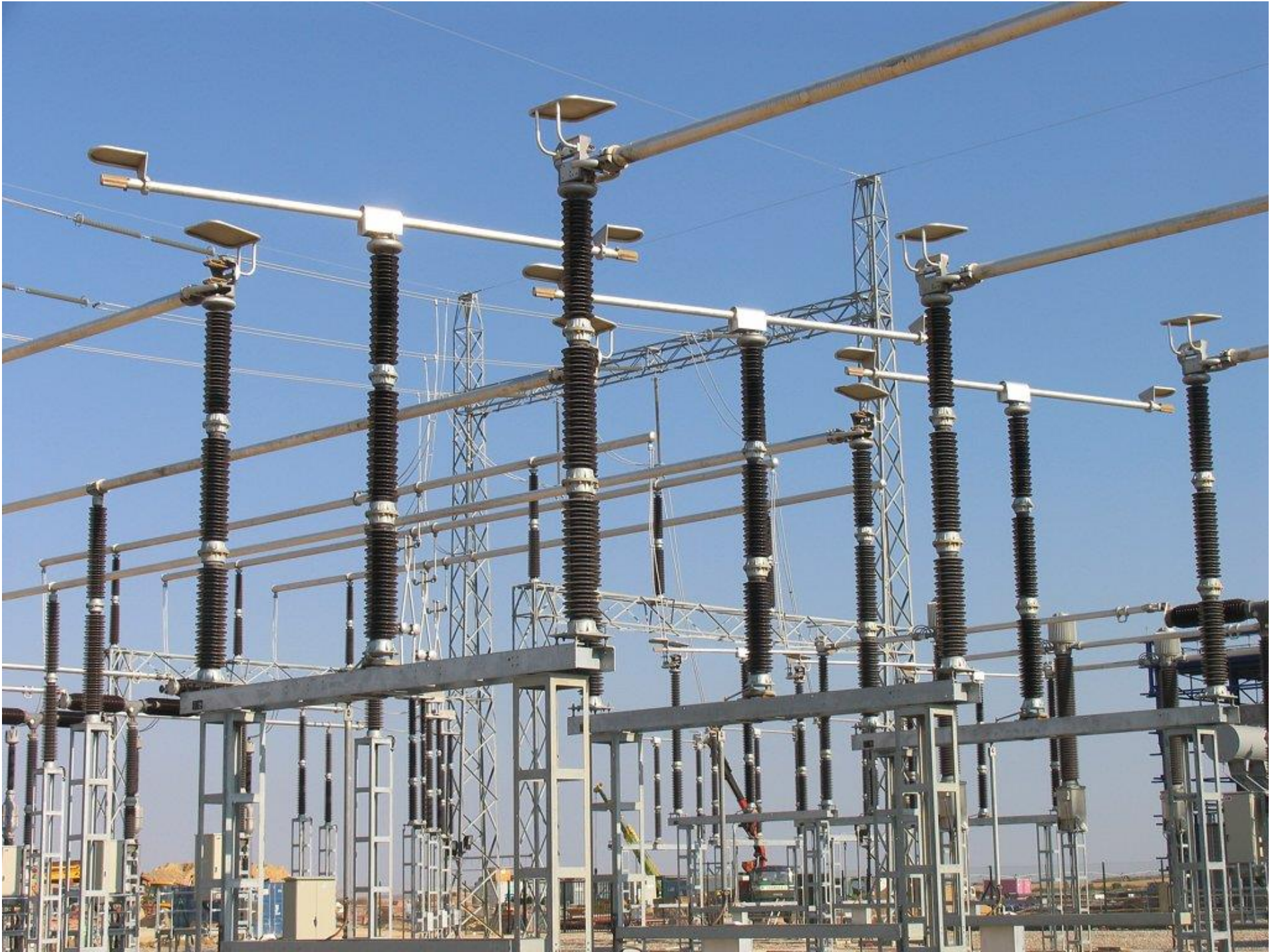
Przykład odłączników napowietrznych poziomoobrotowych dwuprzerwowych 400 kV.
