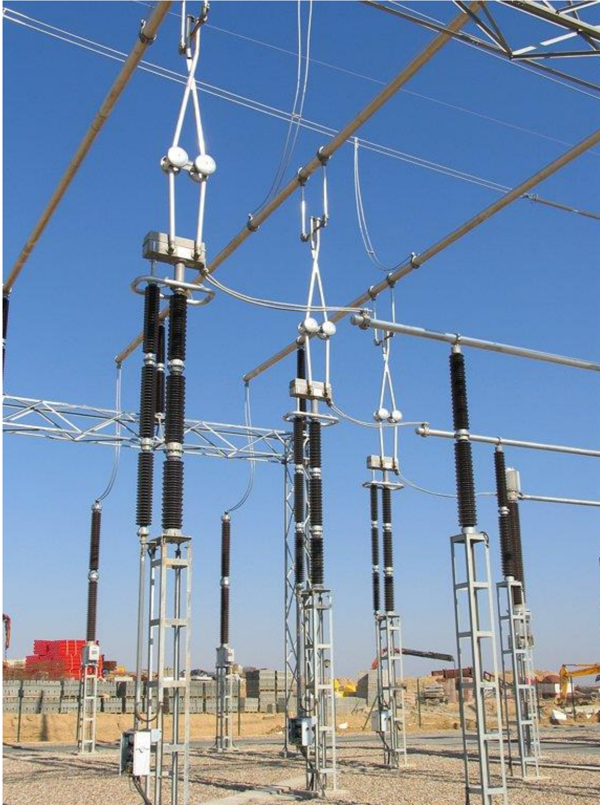
Przykład odłączników napowietrznych pantografowych (nożycowych) 400 kV.
