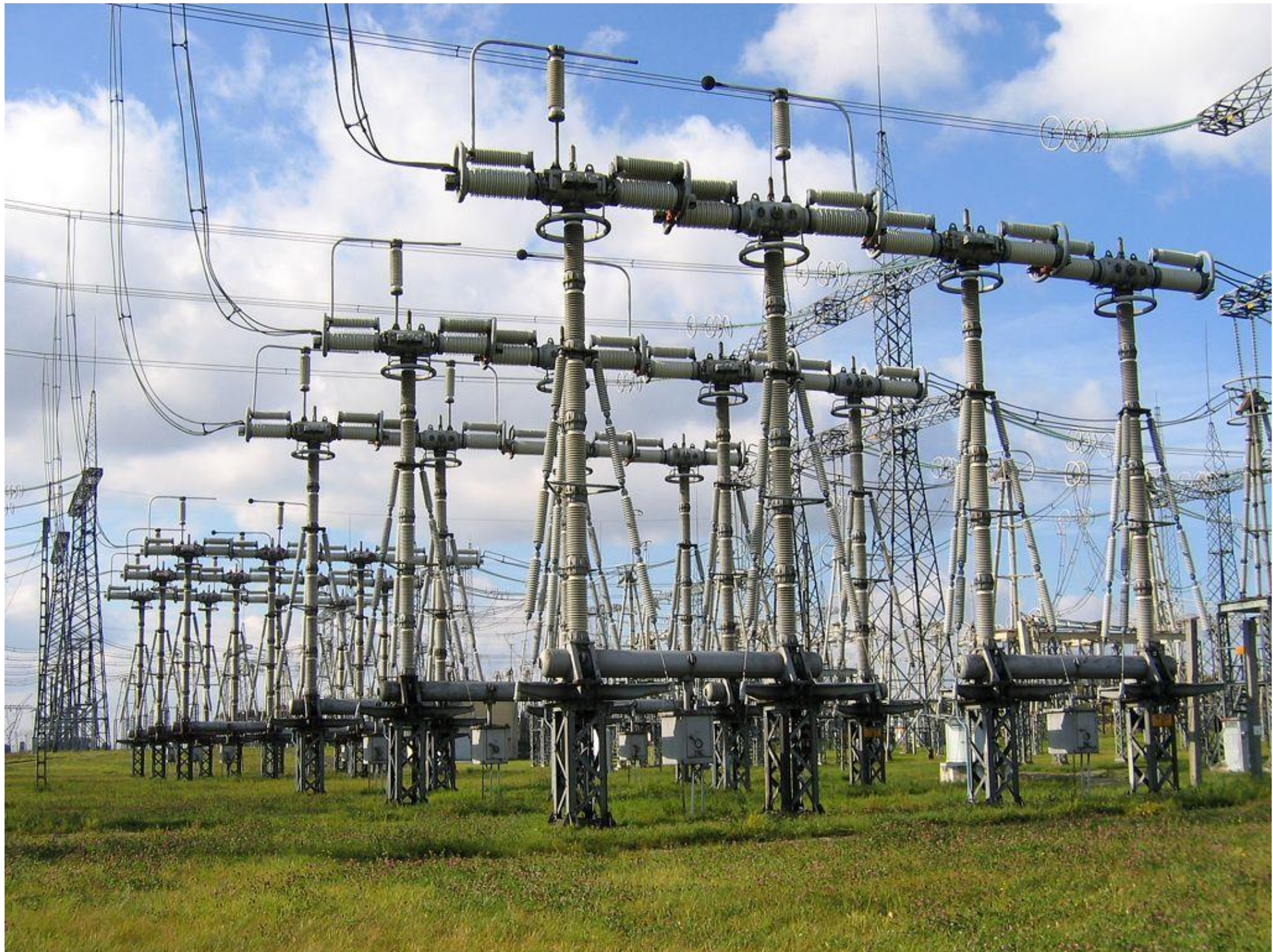
Wyłączniki pneumatyczne w rozdzielnicy 750 kV.
