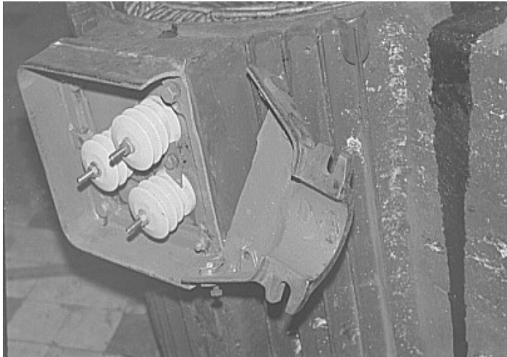
Uszkodzenie mechaniczne skrzynki zaciskowej.
